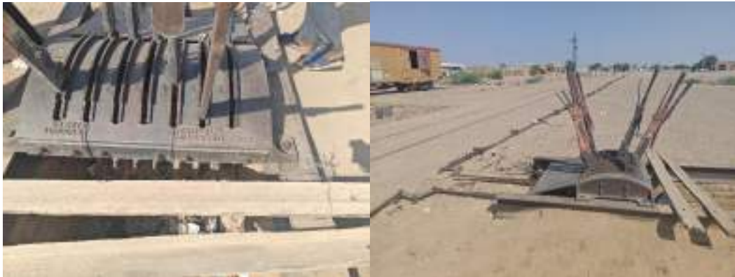
صورة 3-3-14 ( مفتاح تحويلة محطة بربر )
