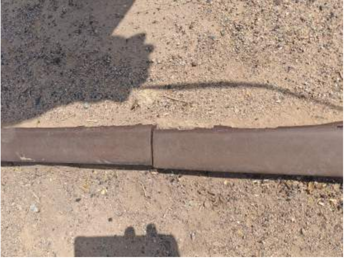
صورة 5-3-3 (تخلل في ربط القضيبين-عدم استقامة حافتا القضيبين)
