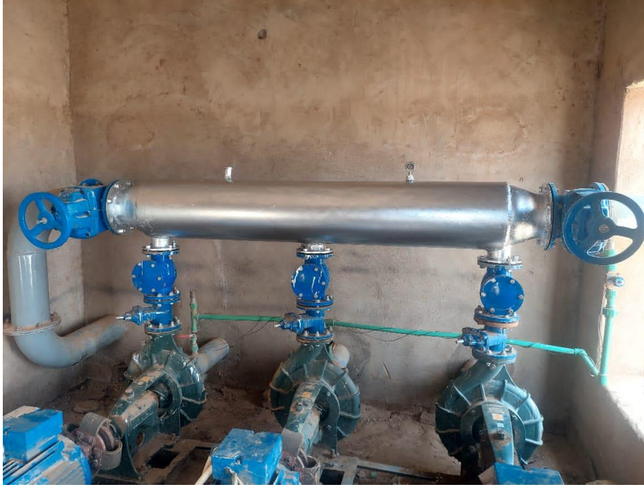
الشكل (15.3) يوضح غرفة مضخات الضغط العالي لضخ المياه الى الشبكة
