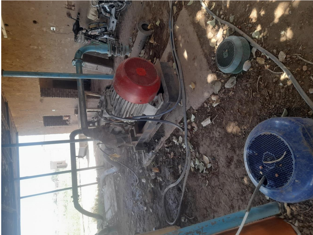
الشكل (6.3) يوضح طلمبة لضخ المياه في الشبكة
