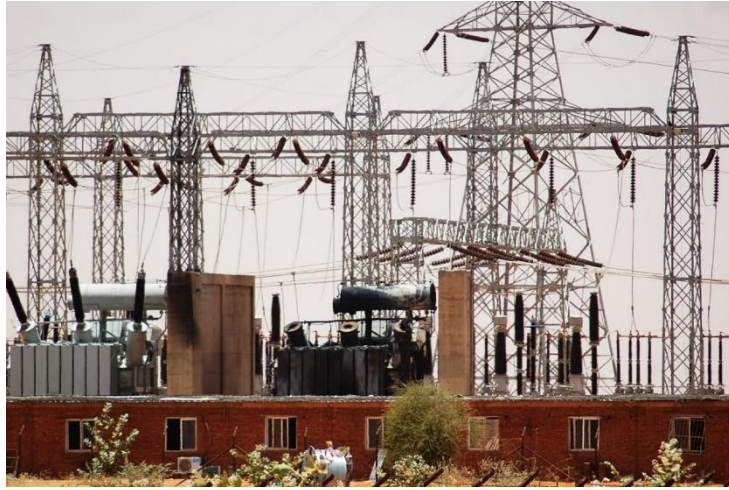
شكل (1-1) : صورة لمحطة شندي التحويلية
